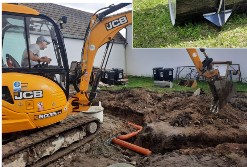
Osádzanie nádrže a napojenie zberových potrubí. Nádrž s kapacitou 10m 3 nadimenzovaná na zber dažďovej vody zo striech a pivnice. Autor foto: Obec Vinosady
